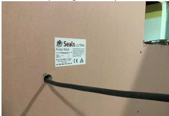
Losse Elektra Kabel
